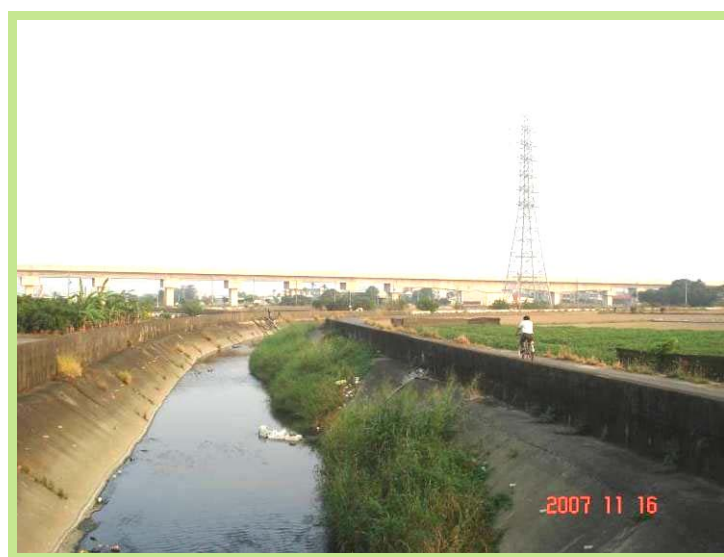
圖 8-7 衛生 1 號排水水岸車道需改善環境現況圖
