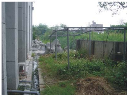
照片3-13 公路局新化工務段後方鄰 虎頭溪之側牆倒塌, 形成防 洪缺口
