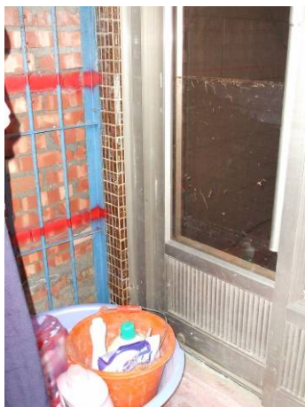
照片 3-73 新豐一號橋附近淹水，住宅其落 地門窗留有約 1 公尺高水痕(96. 8. 22 攝)
