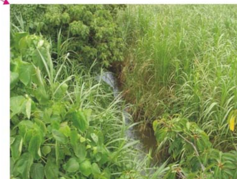
照片3-57 水路橋上游雜草叢生
