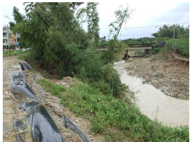
照片 3-70 帝溪橋下游右岸護岸邊坡坍塌 (96. 8. 22 攝)
